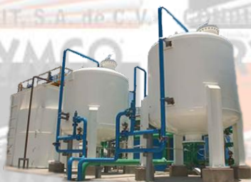
Tratamiento Agua Potable
